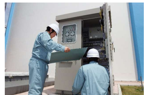
電気設備点検
