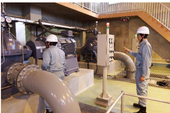
配水ポンプ設備点検
