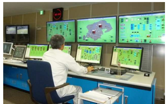
鶴ヶ島浄水場操作室
