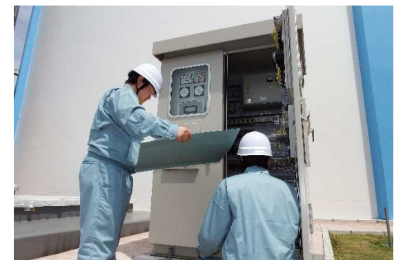
電気設備点検
