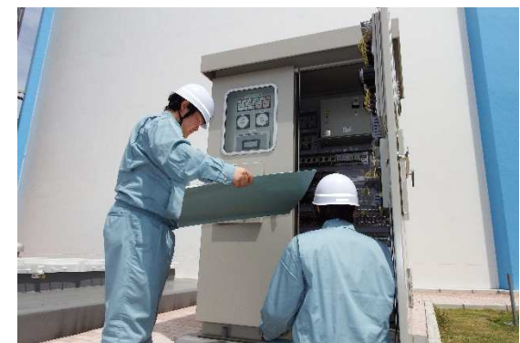
電気設備点検
