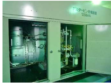
図 4-29 鶴ヶ島浄水場 非常用自家発電機
