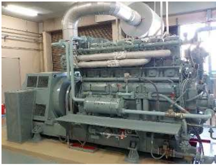
図 4-28 坂戸浄水場 非常用自家発電機
