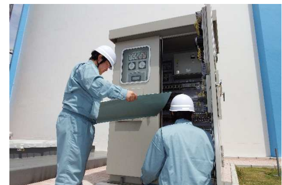
電気設備点検
