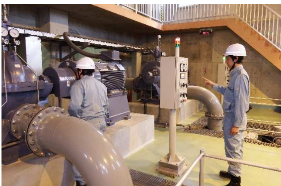
配水ポンプ設備点検
