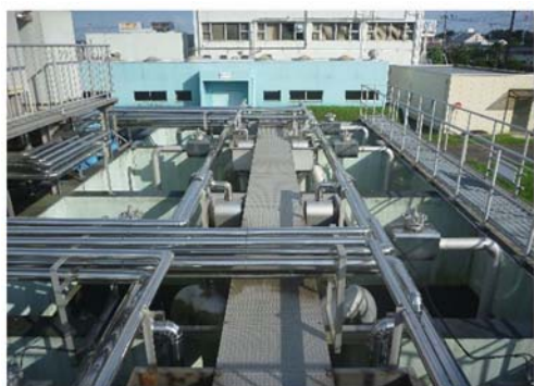
写真5 鶴ヶ島浄水場除鉄除マンガン装置
