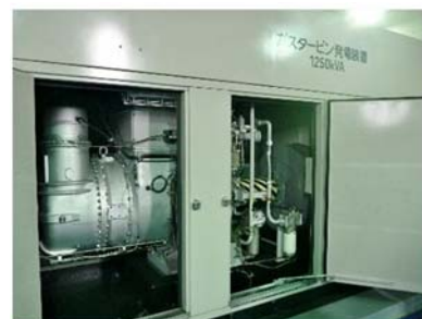
写真 9 非常用自家発電機
